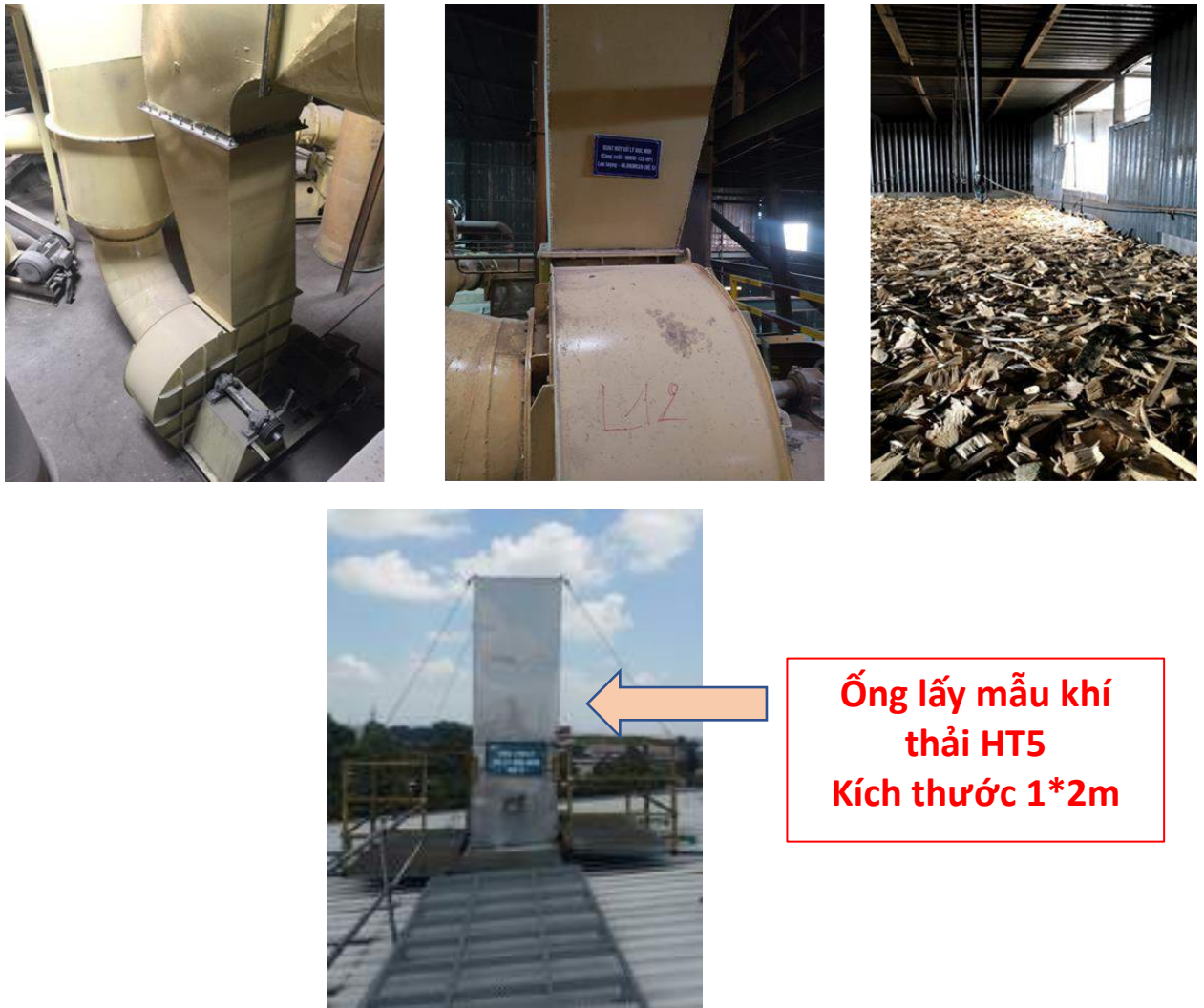
Hình 10: Một số hình ảnh của 2 HTXL bụi, mùi từ công đoạn nghiền, làm nguội công suất 49.000 m³/giờ
